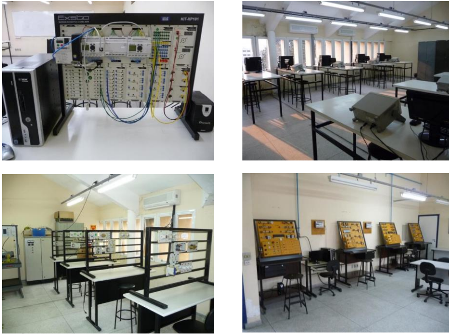
Figura 4 – Laboratórios e equipamentos da Área da Indústria
